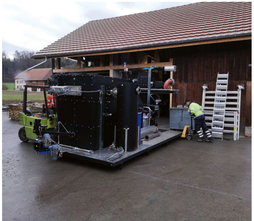
Im ehemaligen Wagenschuppen der Familie Biedermann wurde ein Holzgas-Blockheizkraftwerk installiert. Dieses wurde von der österreichischen Firma Glock auf einer Plattform schlüsselfertig angeliefert.
