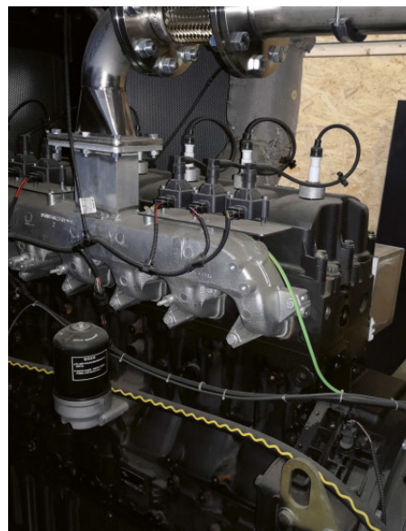
Das Herzstück der Heizzentrale ist ein Sechszylinder-Reihen-Verbrennungsmotor mit 11 300 ccm Hubraum.
