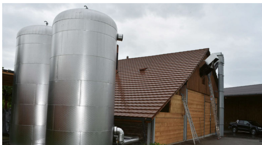
In den 60 m 3 fassenden Silos werden die nassen Hackschnitzel mit Ventilatoren getrocknet.
